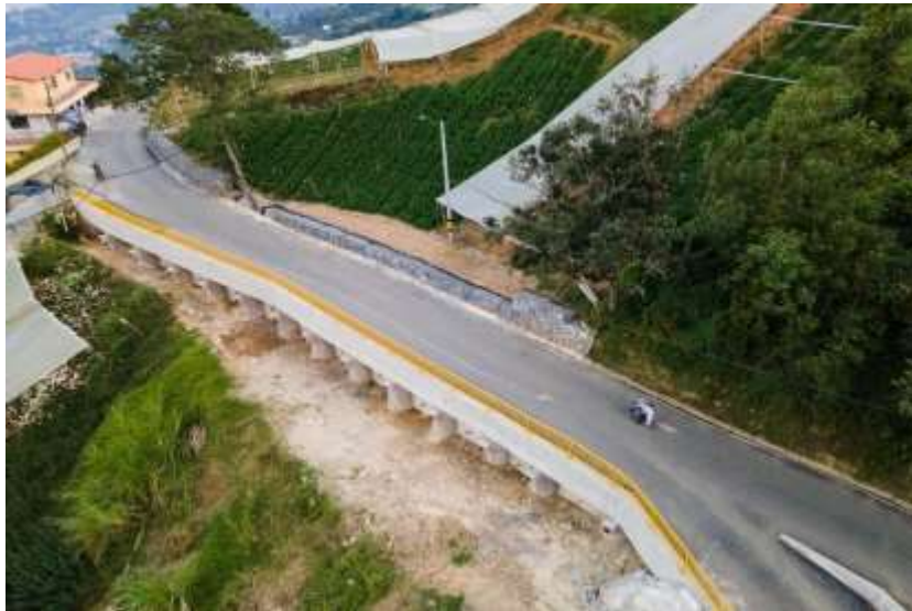
Imagen 32 Obra de contención Vereda La Cuchilla - San Cristóbal
