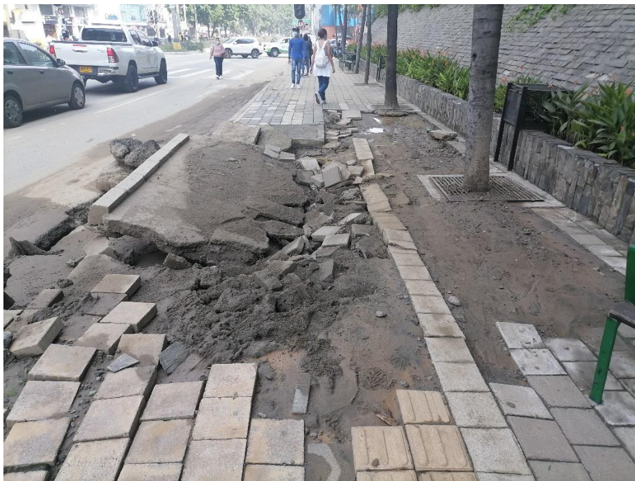
Ilustración 1 desprendimiento de anden y zona podotáctil
