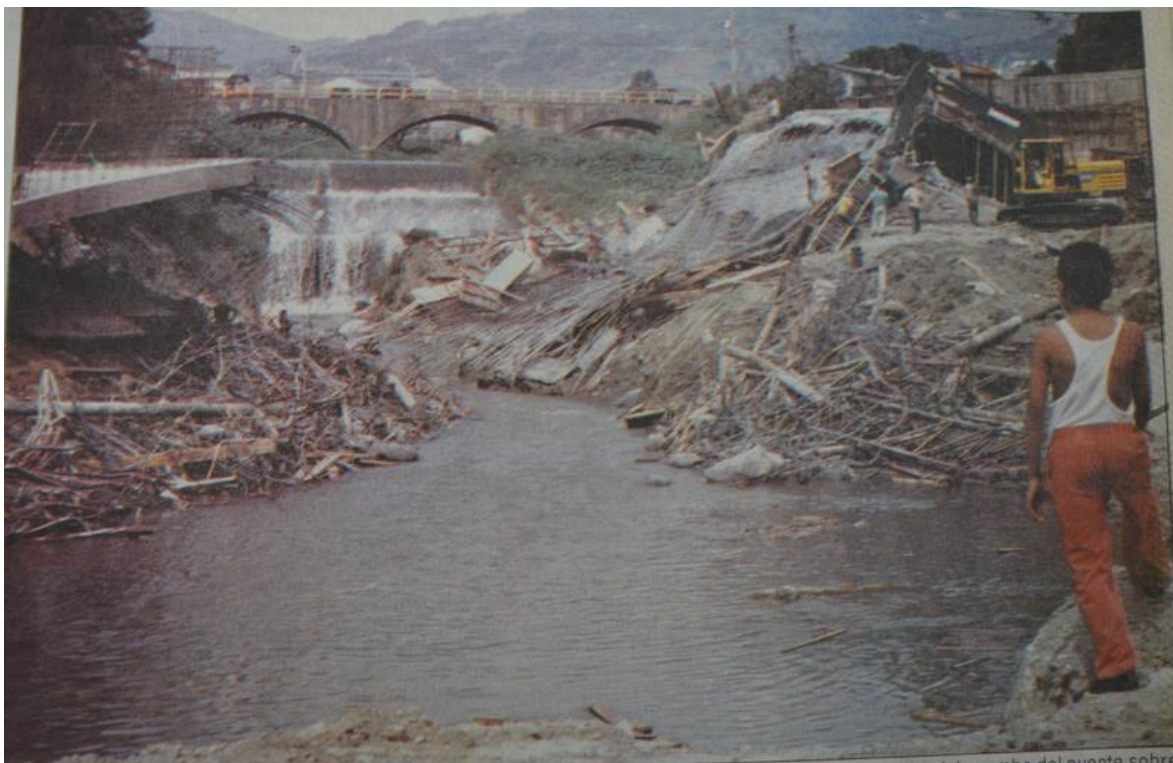
Ilustración 50. El puente roto
