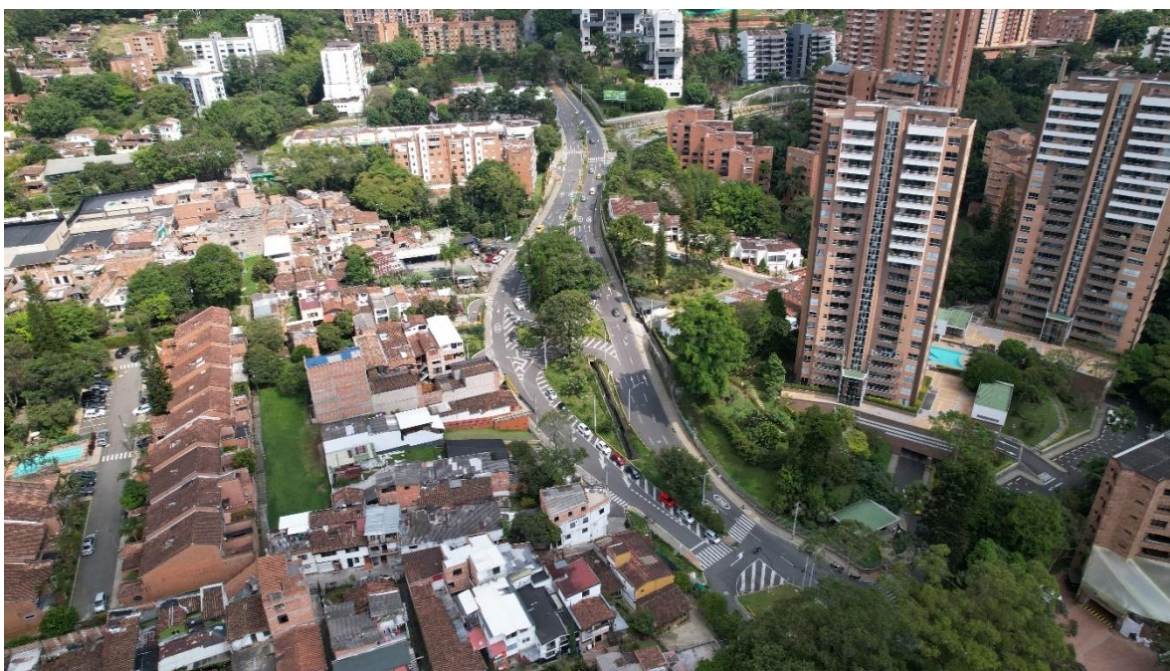
Ilustración 3. Obra paso a desnivel de la transversal inferior con la Loma de Los Gonzalez
