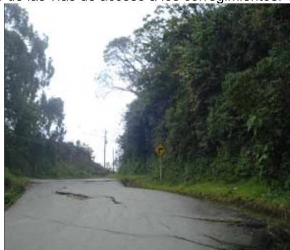
Figura 50. Mal estado de las vías de acceso a los corregimientos. Vía a Alto de Boquerón
