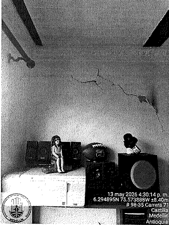
Edificación 2: Aparición de grietas en habitación fontal interior vecino 301 por altas temperaturas
