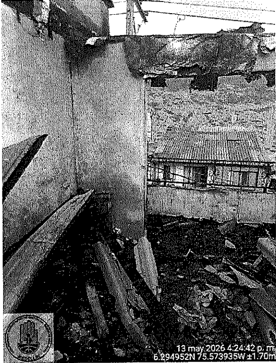
Edificación 1: Colapso de cubierta parte frontal del interior 301 sala de estar y balcón
