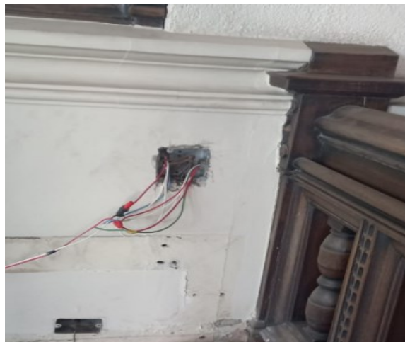
Fotografía 5 Salida de caja de paso.
