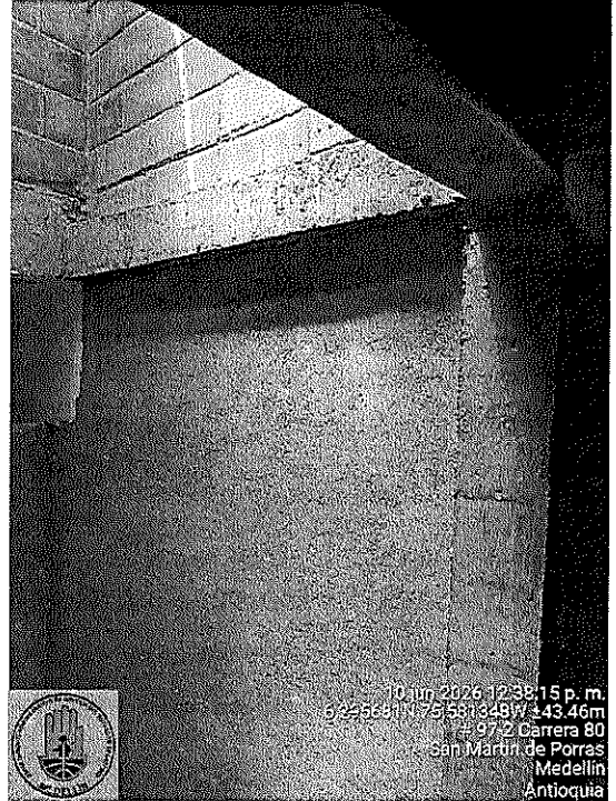
Fisuras en sección posterior exterior del interior 302
