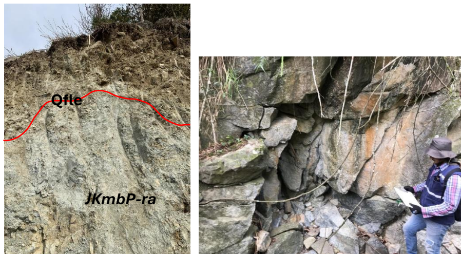
Ilustración 14. Nivel IIA y roca fracturada reportada sobre la margen derecha de la quebrada Malpaso
