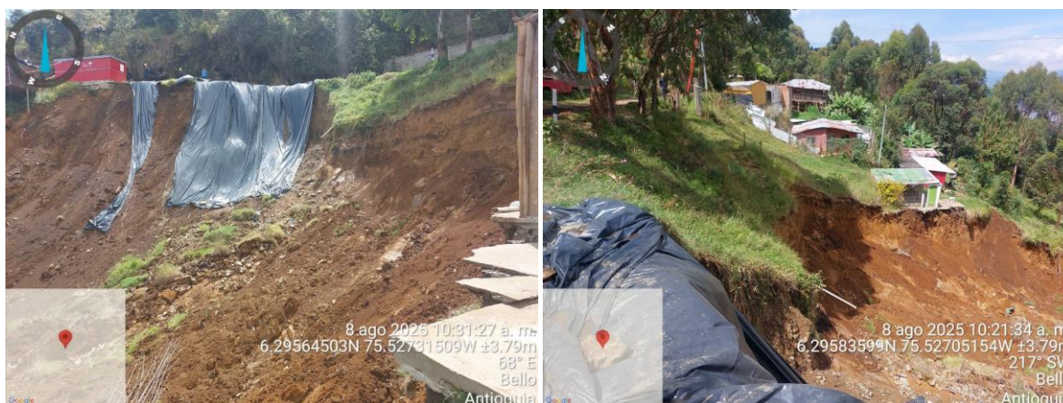
Ilustración 72 Elementos expuestos en el área de la corona del deslizamiento
