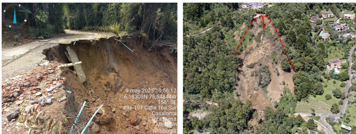
Ilustración 73 Evidencias del deslizamiento ocurrido en el sector Loma Los Balsos
