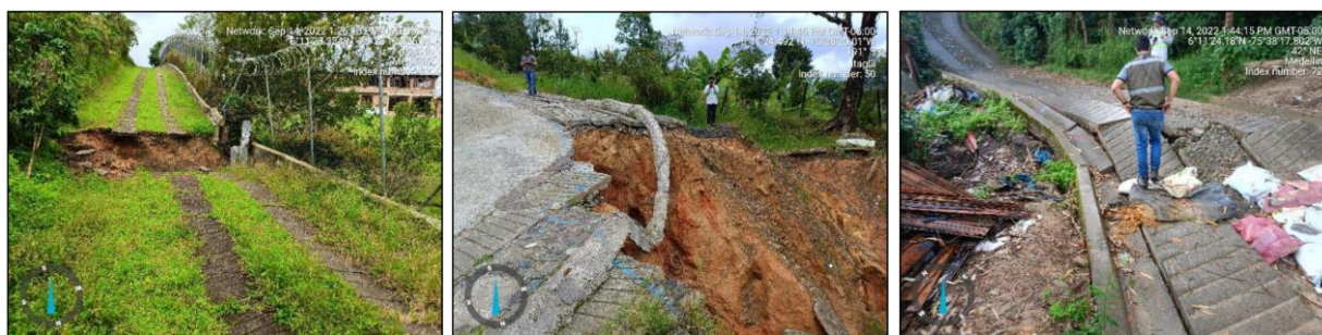
Ilustración 66 Evidencias del deslizamiento observadas durante las inspecciones de campo
