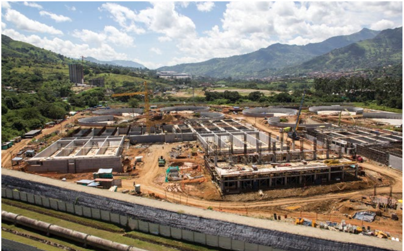
[Avance de obra] Planta de Tratamiento de Aguas Residuales de Bello Aguas Claras
