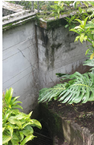
Obra hidráulica de entrega a la salida del lote
