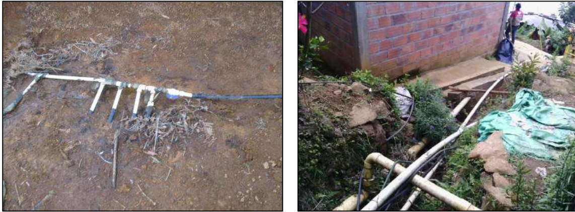
Figura 4. Redes antrópicas de servicios instaladas por la comunidad encontradas en el Polígono El Faro
