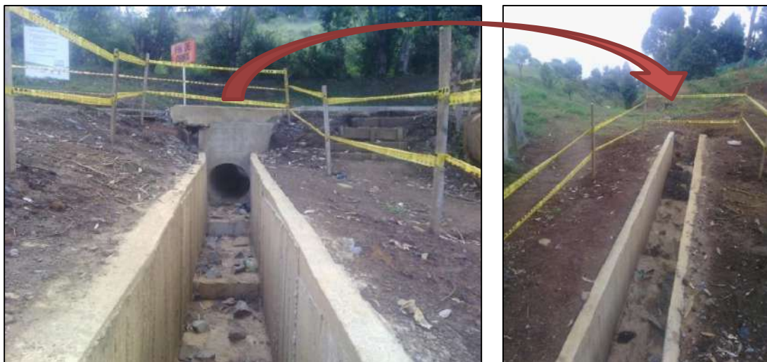
Figura 169. Tramo en canal de concreto con fondo escalonado en piedra pegada de la Quebrada Chorro Hondo 1
