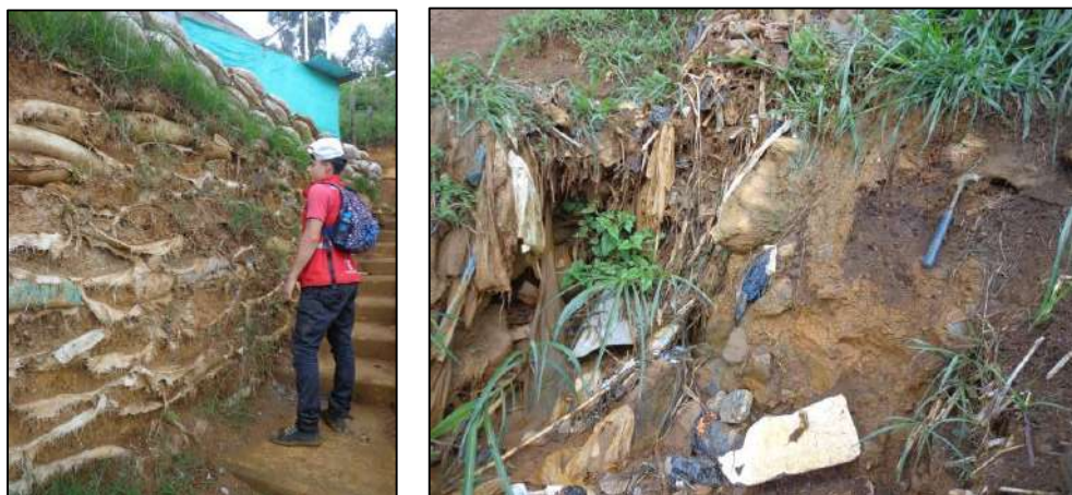
Figura 9. Llenos antrópicos en el Polígono El Faro A) Como base para vivienda y B) Cerca de la Quebrada Chorro Hondo
