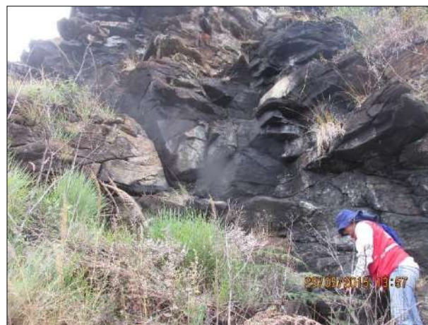
Figura 50. (A) Macizo rocoso con discontinuidades que favorecen la caída
