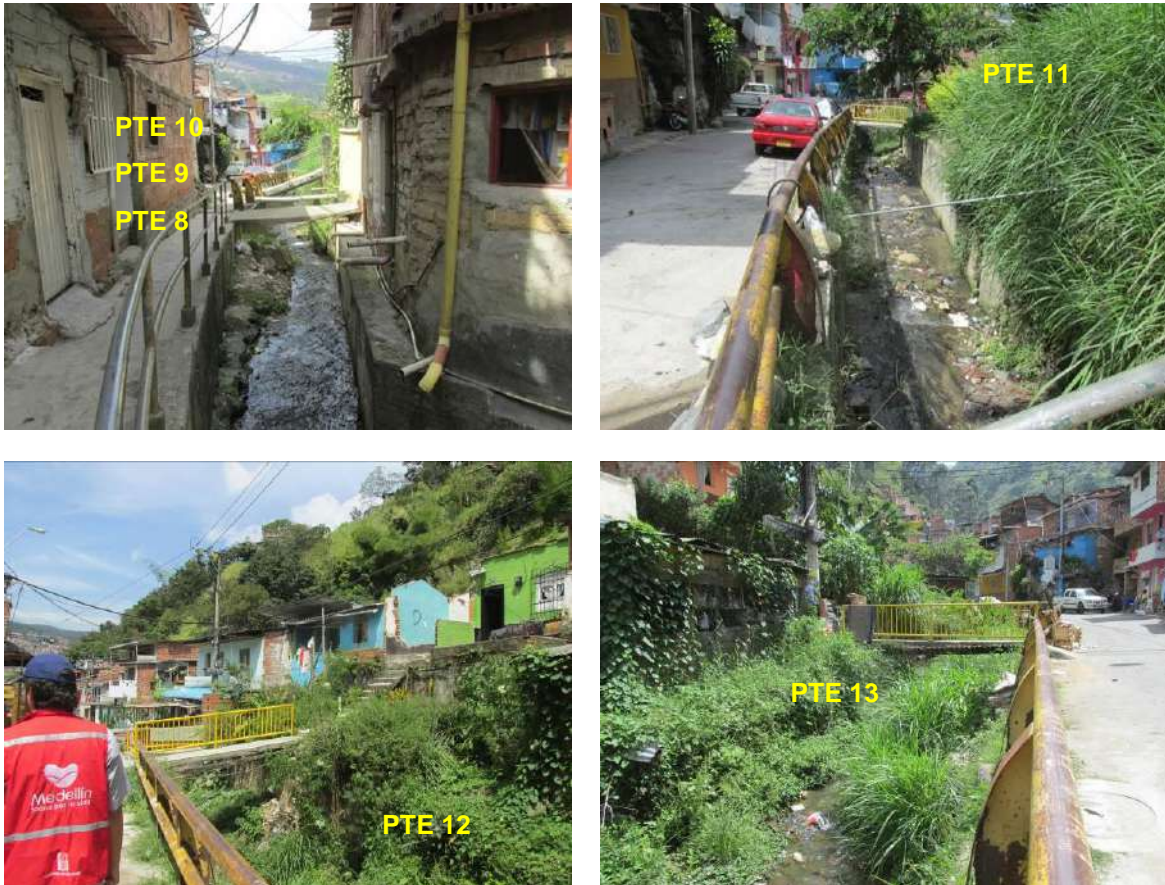
Figura 188. Puente PTE 8 ubicado en Tramo 2 y Puentes PTE 9 a PTE 13 ubicados en el Tramo 3 de la Quebrada La Castro
