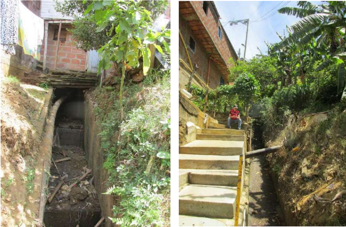
Figura 193. Parte inicial del tramo analizado de la Quebrada San Antonio correspondiente a un canal en concreto
