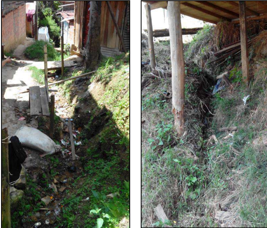
Figura 6. Panorama de las condiciones de los afluentes de la Quebrada La Castro al interior del Polígono Esfuerzos de Paz
