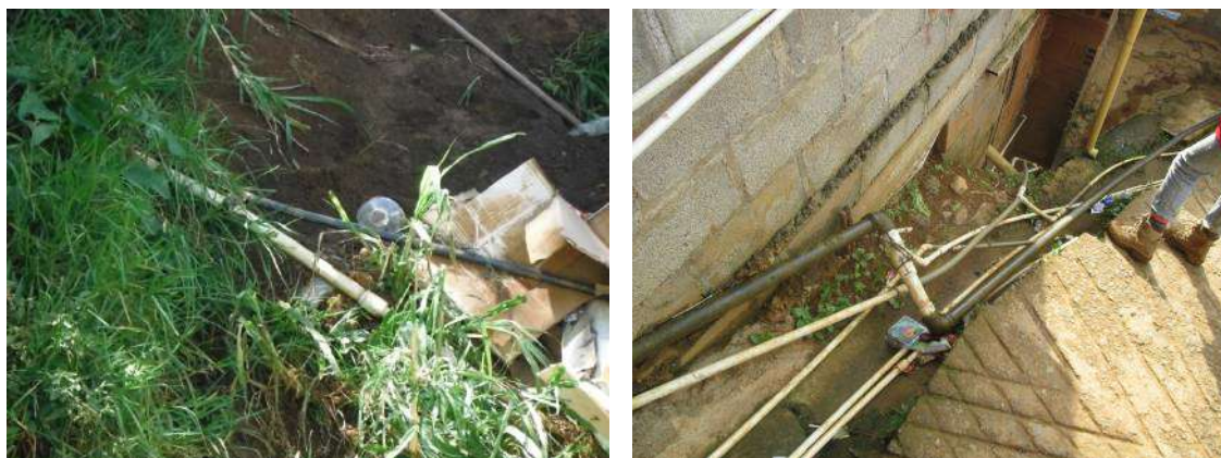
Figura 4. Redes antrópicas de servicios instaladas por la comunidad encontradas en el Polígono Golondrinas
