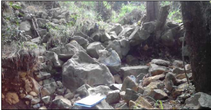
Figura 11. Condiciones actuales del Drenaje La Loca (Continuación)
