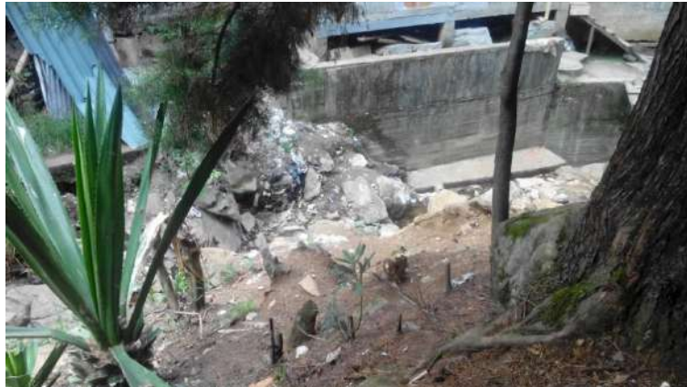
Figura 174. Invasión del cauce de la Quebrada La Loca con muros
