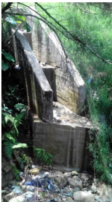
Figura 173. Descarga de aguas residuales a la Quebrada la Loca
