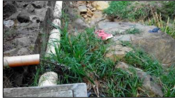
Figura 171. Tuberías de descarga y conducción de agua
