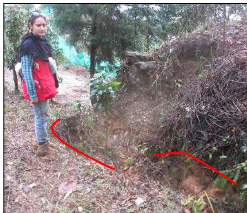
Figura 61. Socavación lateral en la Quebrada Chorro Hondo
