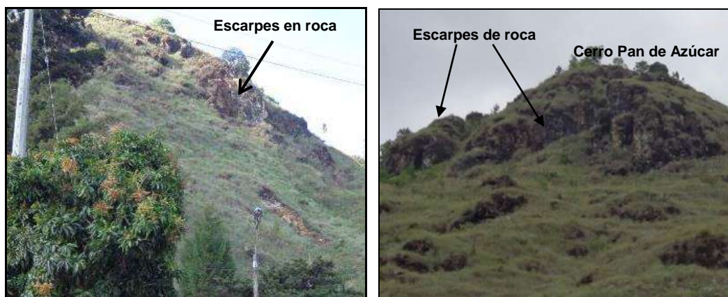
Figura 37. Escarpes de roca en la parte alta de la UMI con alto grado de fracturamiento
