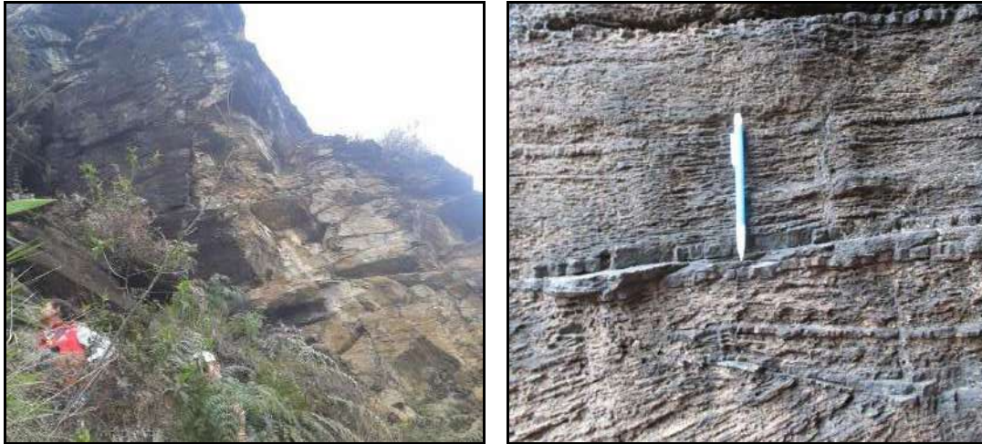
Figura 14. Paredes de roca, localizadas en la parte alta de la UMI sobre unidades geomorfológicas de escarpes y lomos
