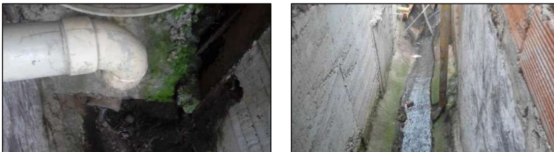
Figura 131. Entrega de aguas residuales al canal trapezoidal (Estructura 6)
