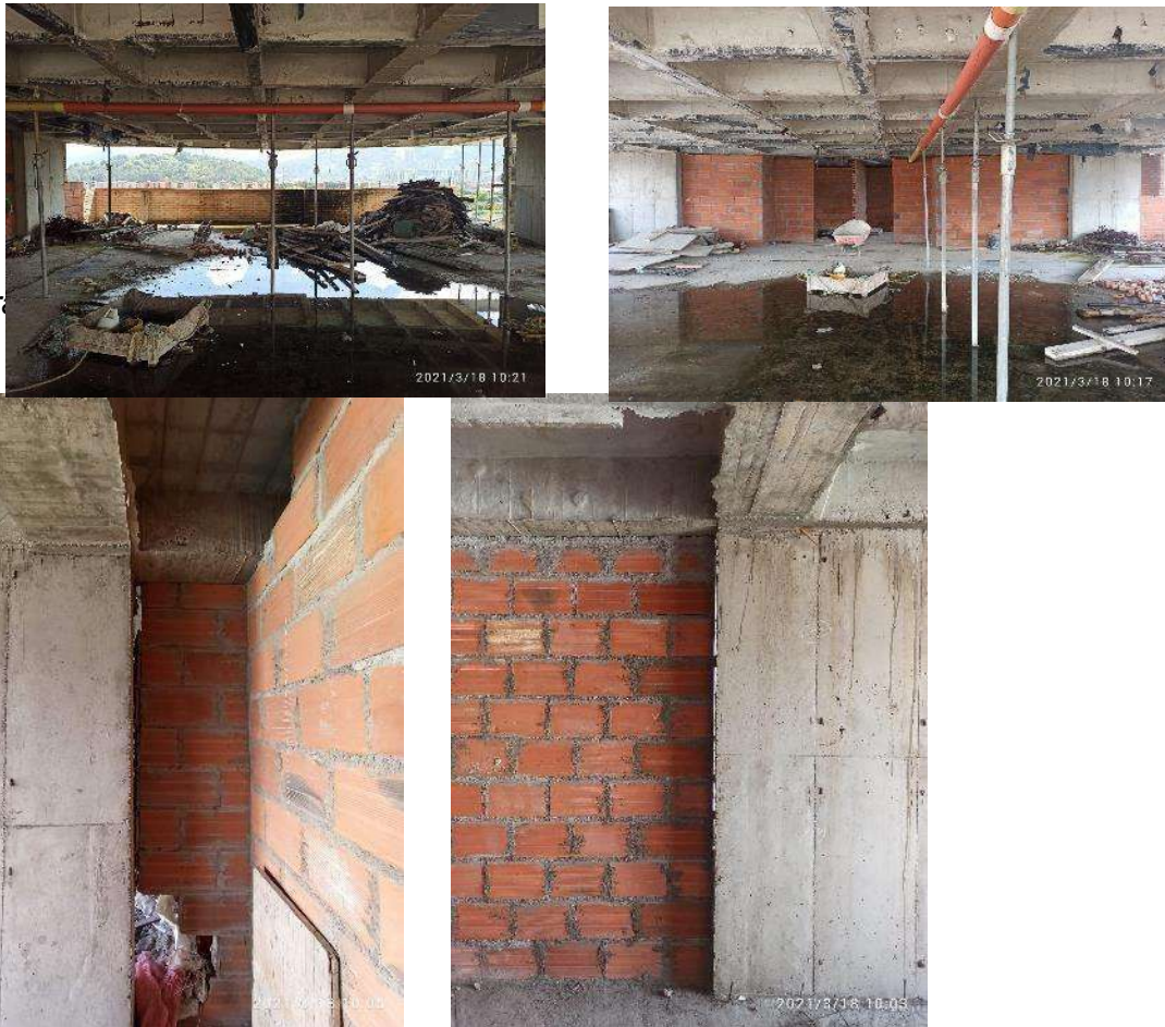
Figura 6: Muros en mampostería separados de los elementos estructurales y deficiencias en los procesos constructivos.
