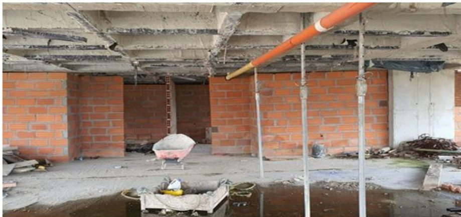
Foto 11. Vista interior del octavo piso con evidencia de estructuras deflectadas . Proyecto Alabama localizado en la Calle 30A 69-08.
