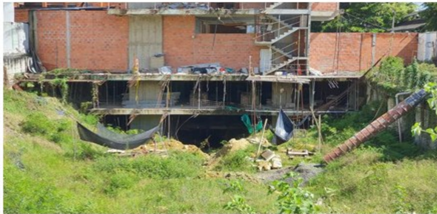
Foto 5. Vista exterior del sótano y primer piso del sector la edificación en construcción del proyecto Alabama localizado en la Calle 30A 69-08.
