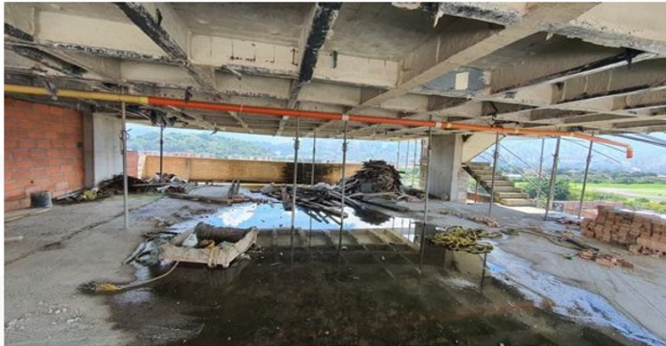
Foto 10. Vista interior del octavo piso con evidencia de estructuras deflectadas . Proyecto Alabama localizado en la Calle 30A 69-08.
