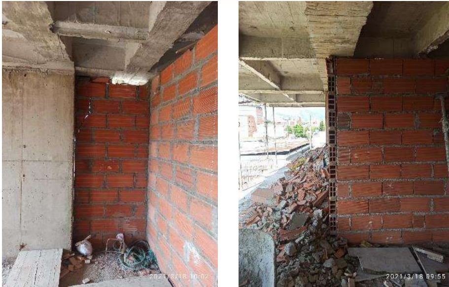
Figura 7: Muros en mampostería separados de los elementos estructurales, mampostería fracturada y deficiencias en los procesos constructivos.
