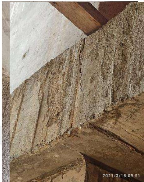
Figura 8: Vigas fisuradas y deficiencias en los procesos constructivos.
