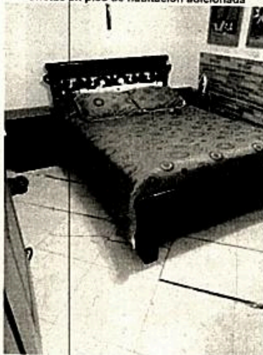
Grietas en piso de habitación adicionada
