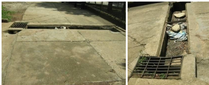
Foto 40. Calle 86 A. Sumidero en mal estado.
