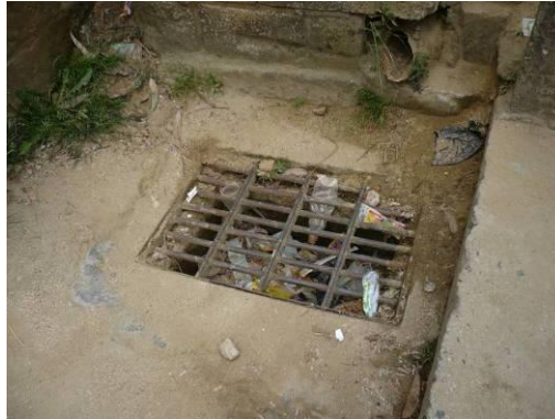
Foto 93 Acumulación de residuos y vegetación en obras de drenaje
