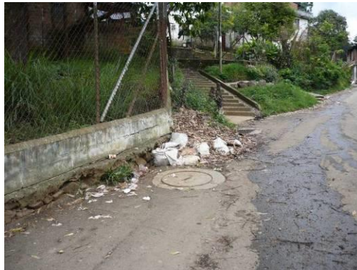
Foto 94. Taponamiento de estructuras hidráulicas por acumulación de residuos
