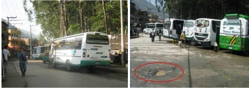
Foto 59. Estado de la capa de rodadura
