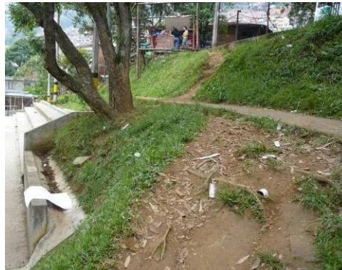
Foto 89 Deficiente sistema de drenaje que causa inundaciones en canchas de microfútbol
