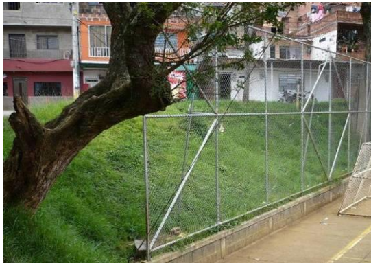
Foto 69 Individuos en riesgo de volcamiento.
