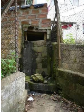
Foto 88 Vertimiento de aguas lluvias y residuales en sendero peatonal
