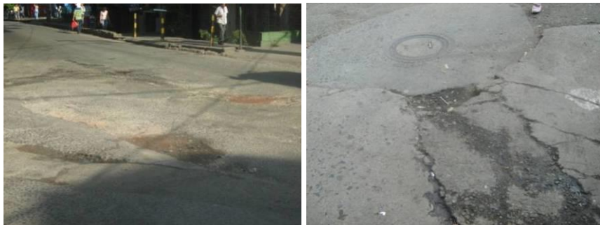
Foto 34. Carrera 36 Estado del Pavimento Vías colectoras
