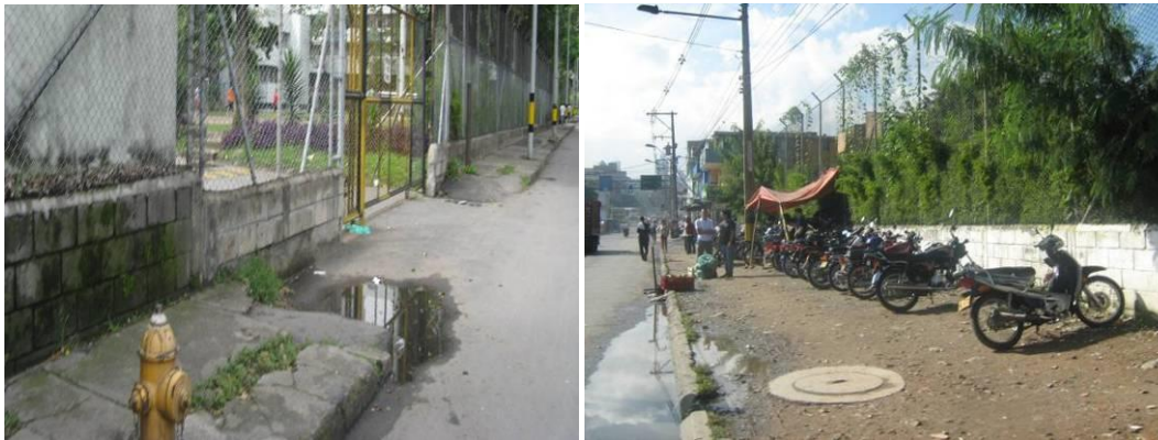
Foto 46. Andenes en mal estado Z3_API_15.
