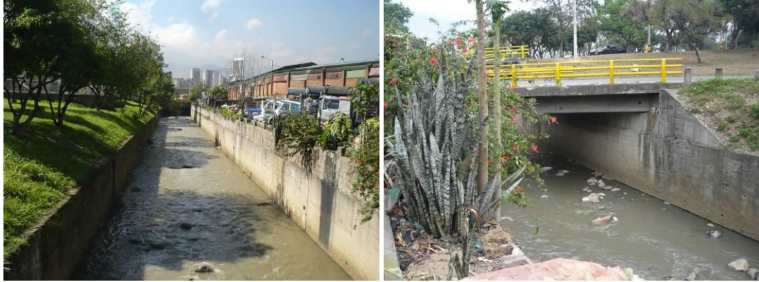
Foto 17. Canal rectangular en concreto a través del cual es conducida la quebrada Santa Elena
