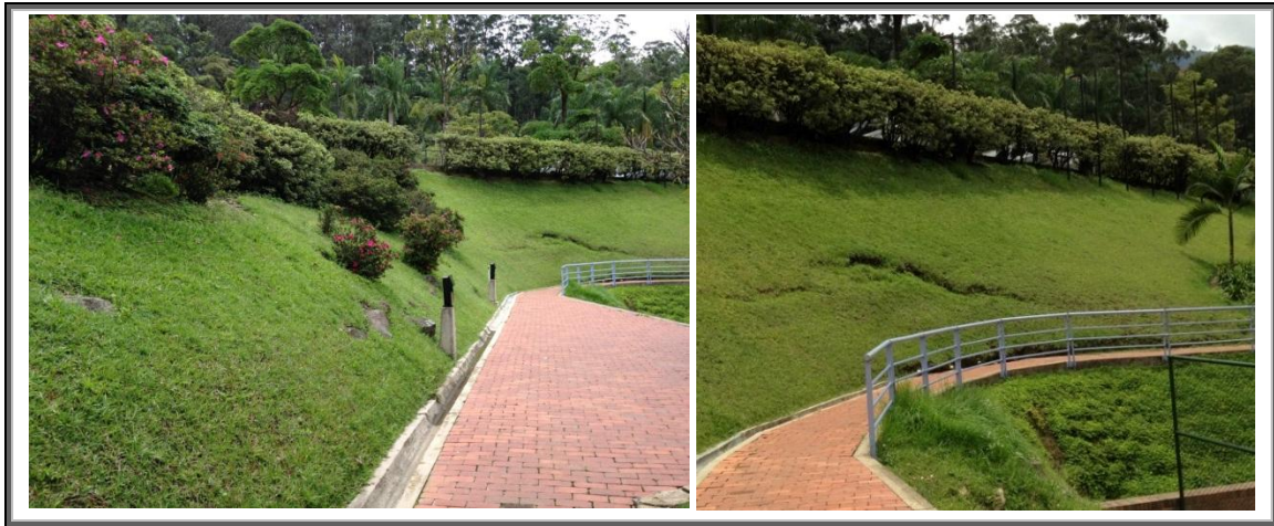
Ilustración 14 Procesos de deslizamiento costado nororiental del Club
