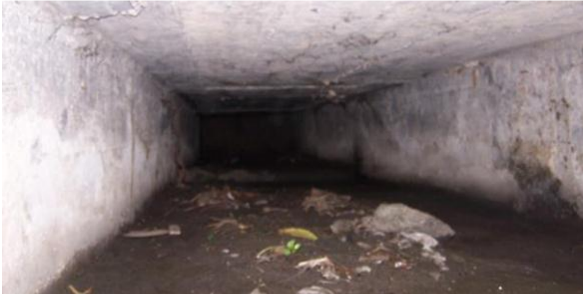
Figura 98. Estructura de conducción al interior del predio.
