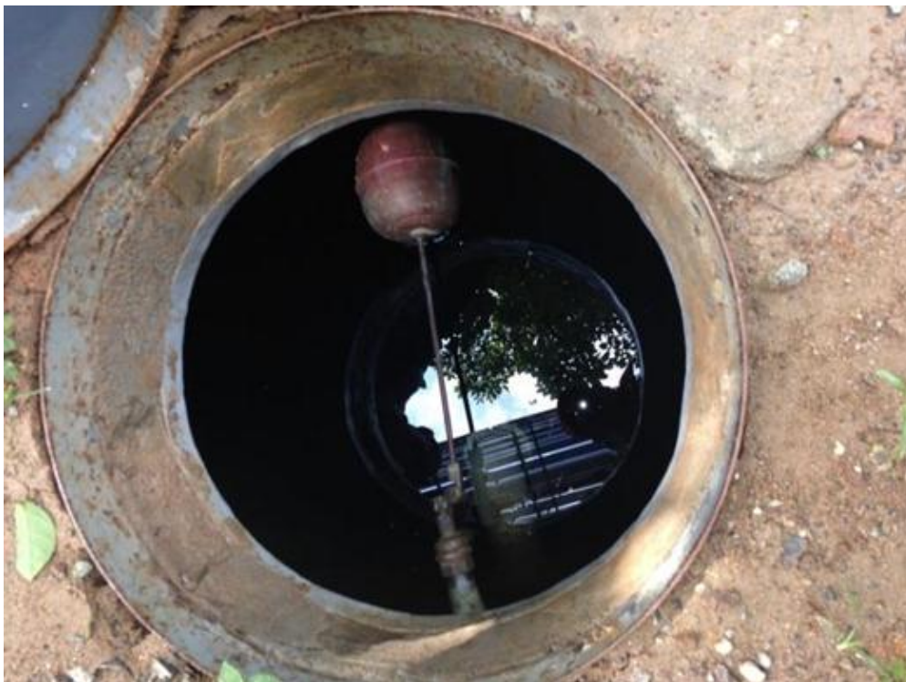
Figura 95. Tanque de almacenamiento cerca de “Castropol In”.
