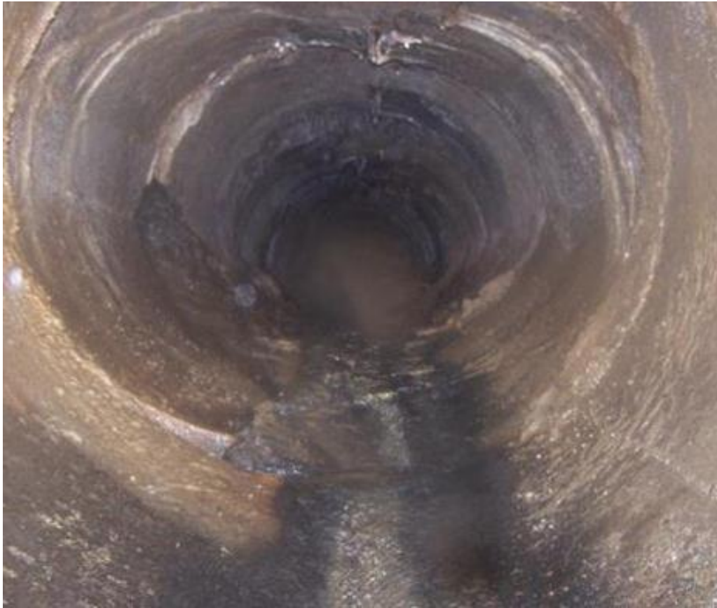
Figura 92. Tubería de 36" que conduce las aguas asociadas a niveles freáticos hacia el predio.
