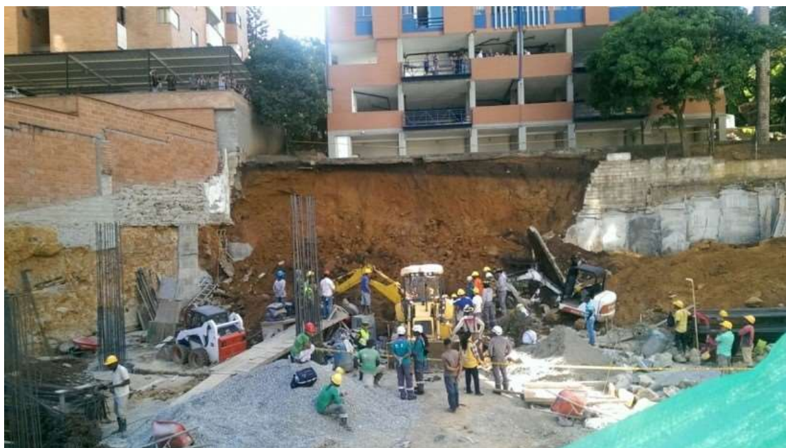
• Fuente: Deslizamiento- HBS Noticias
