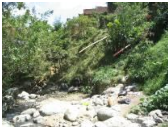
FOTO 77. Vertimiento de aguas residuales e invasión de área de retiro
