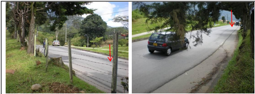
FOTO 138. Aspecto de la grieta que presenta la vía a San Antonio Prado
