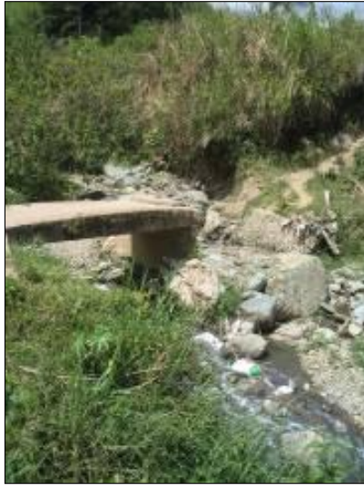
FOTO 85 Estructura afectada por evento torrencial
