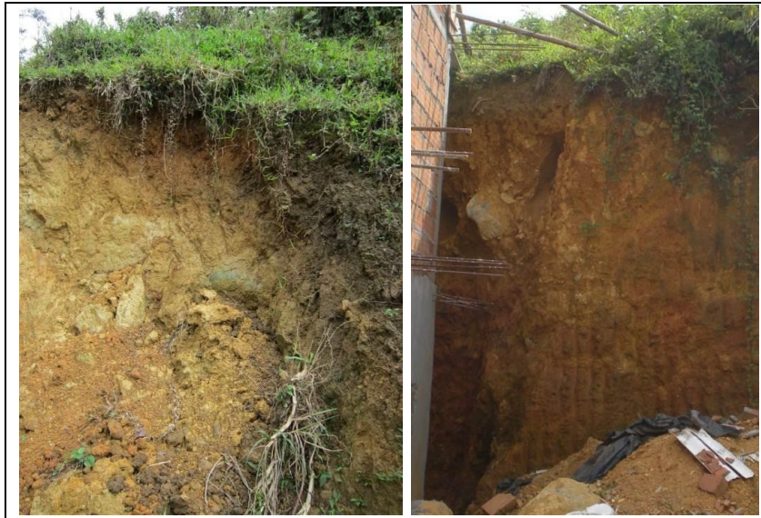
FOTO 95. Aspecto del depósito de flujo de lodo y/o escombros en el talud izquierdo de la quebrada La Jacinta o la Mauala y en un talud de la ladera en la zona del Vergel.
