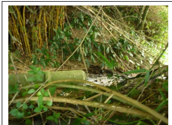
FOTO 63 Conducción por tubería en la quebrada La Cabuyala
