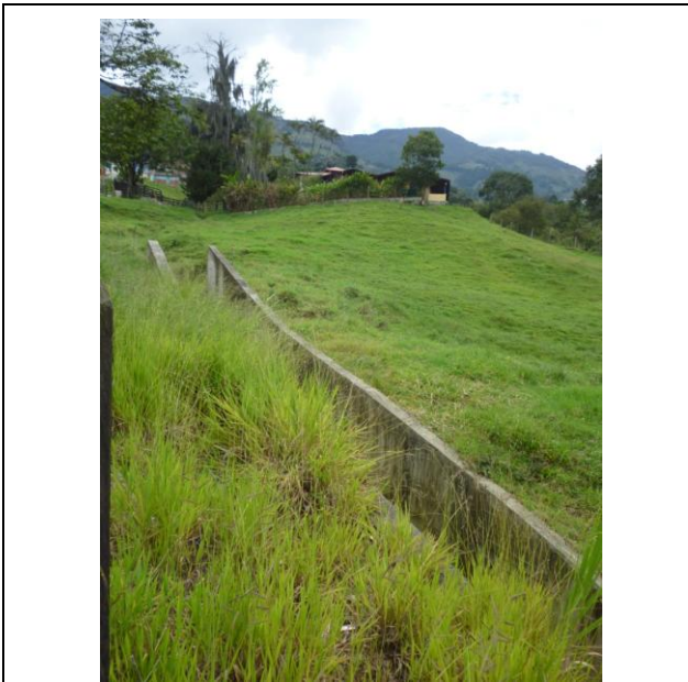
FOTO 45 Obras de disipación en la escorrentía de la quebrada La Maula por el margen derecho.
