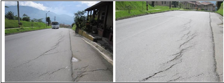
FOTO 102. Panorámica del área afectada sobre la vía de acceso al corregimiento de San Antonio de Prado.
