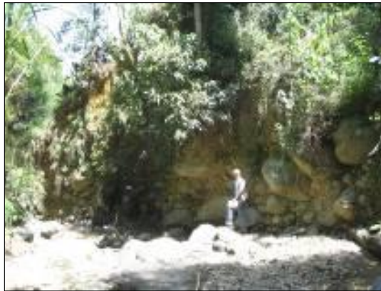
FOTO 81 Deslizamiento del talud
