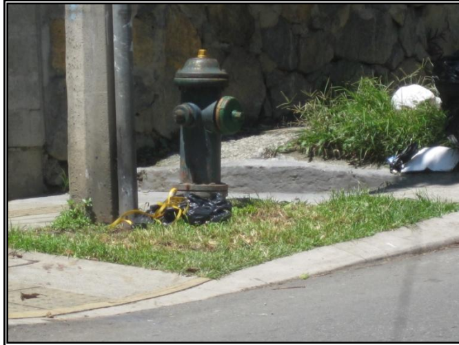
Imagen 22. Hidrante 150mm sobre la Carrera 22
