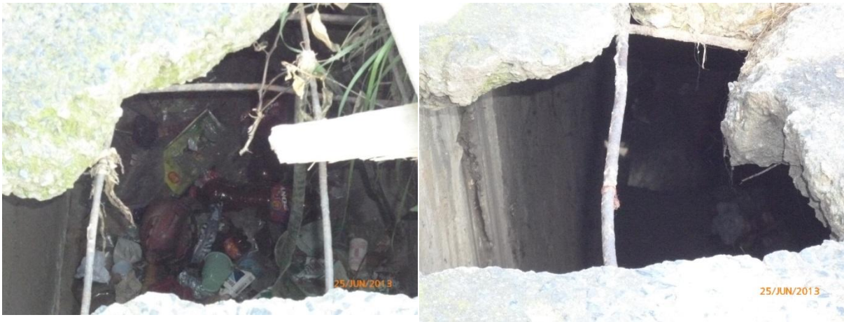
Imagen 4. Andén fallado en la parte posterior del área de intervención
