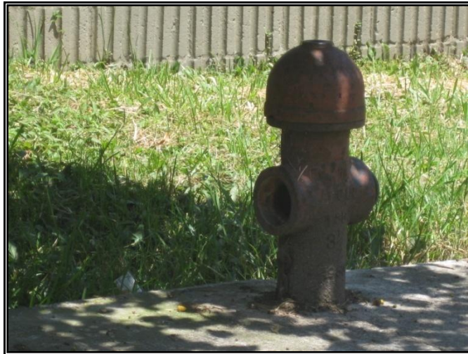
Imagen 24. Hidrante fuera de operación sobre la Calle 49
