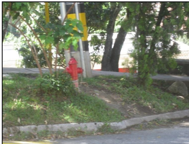
Imagen 23. Hidrante sobre la Carrera 22 con Calle 50
