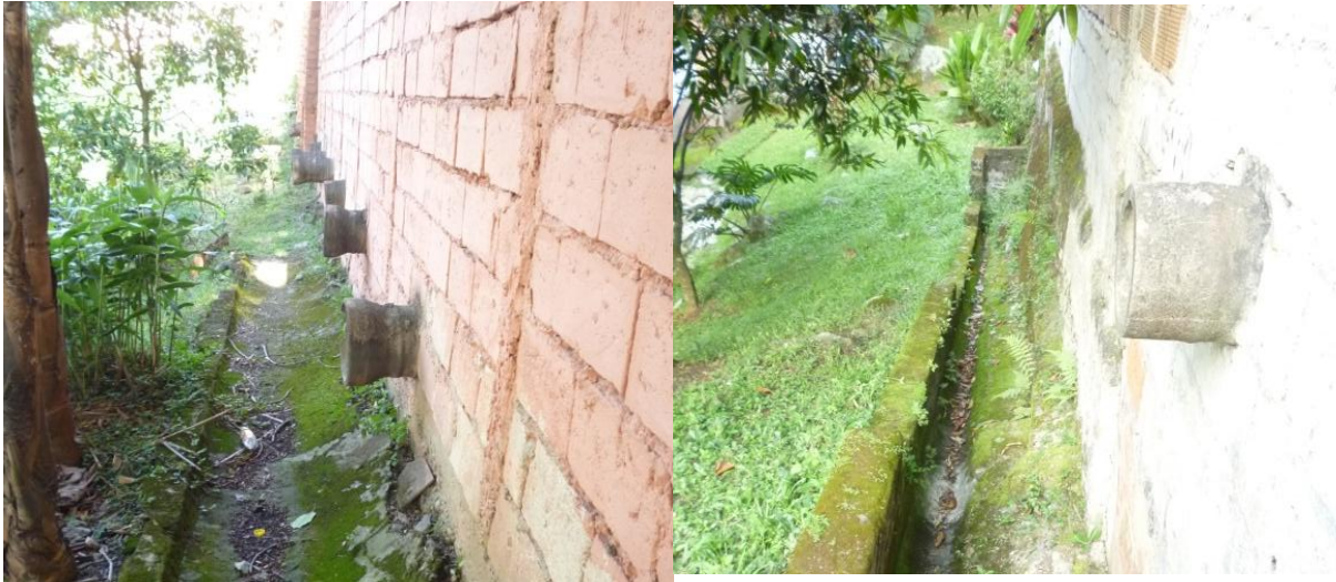
Imagen 5. Tubería de concreto que conecta el andén fallado y la vaguada interna
